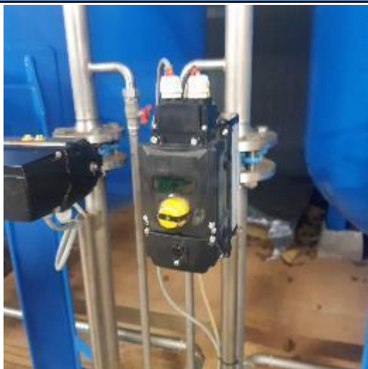
Vanne mise à l'air libre filtre n°3
